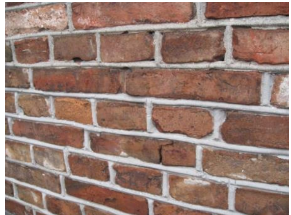
Storegade 3 – brændte fuger
