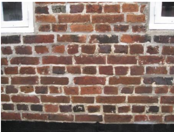
Storegade 7 – munkesten, fyldte fuger
