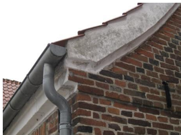
Storegade 7 - muret gesims, opskalkning, muranker
